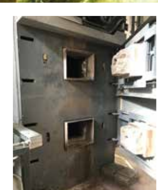
Holzhackschnitzelheizungsanlage in der Studentensiedlung
